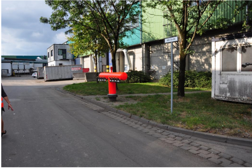
圖 12 消防設施一隅，該廠十分注重消防安全
