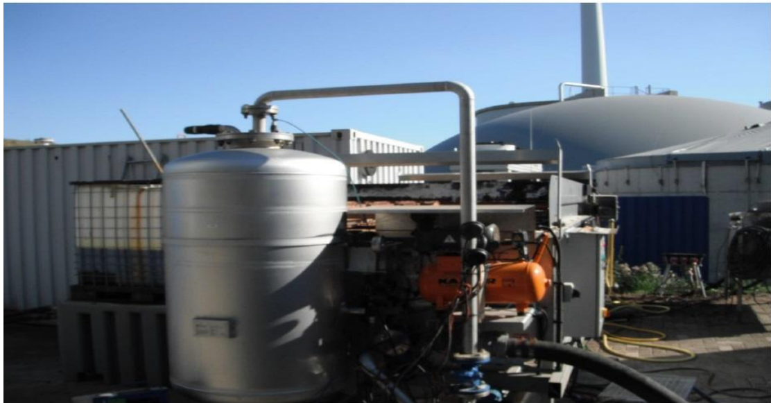
圖 32 沼氣純化加壓設備
