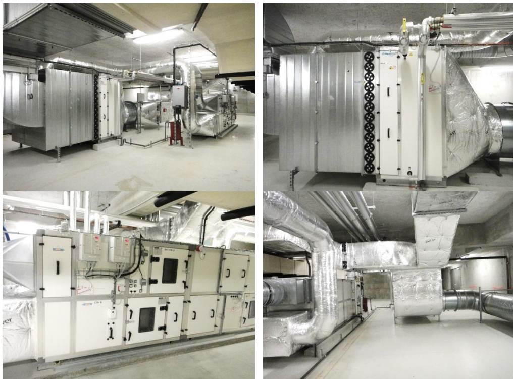
圖 4-41 羅納省檔案館空調機房(8樓) (來源：自行拍攝)
