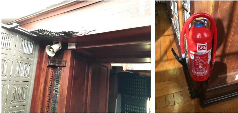
圖 3- 64 歷史檔案中心之廣播設備及水霧式手提滅火設備 (來源：自行拍攝)
