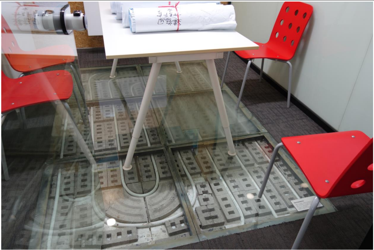
圖 7、7/29 天友綠色設計中心 工作室之地面供冷、供熱系統
