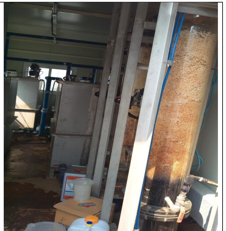
圖24_口蹄疫掩埋區域地下水處理設施
