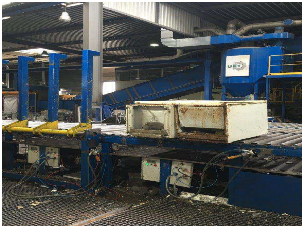
冷媒及壓縮機潤滑油抽取設備
