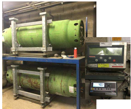
冷媒貯存計重設備
