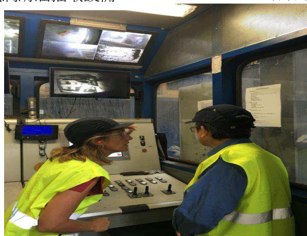
CCTV 及電腦監控系統
