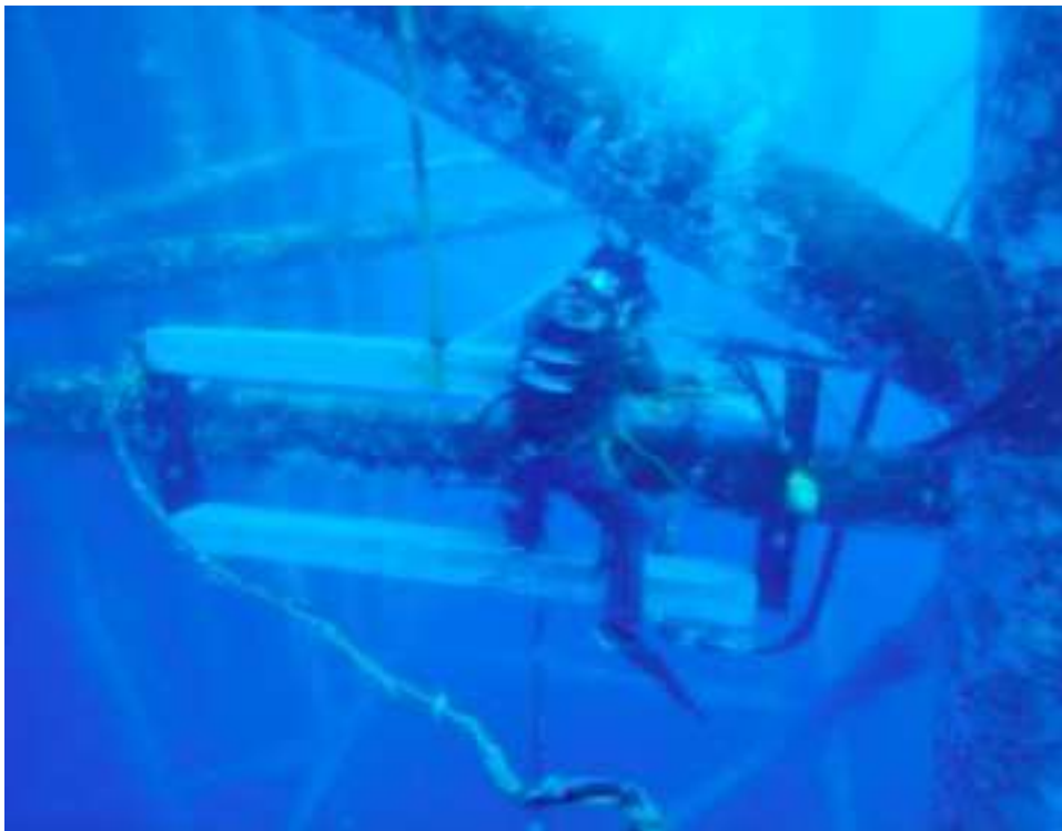
圖一 水下結構的防蝕設施
