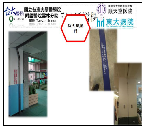
▲日本東大鐵捲門的警告標示
