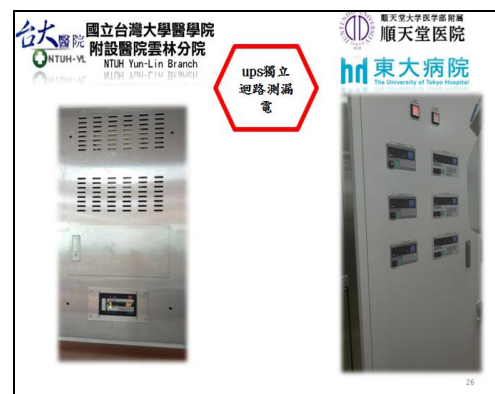
▲日本醫院有將漏電線路整併
