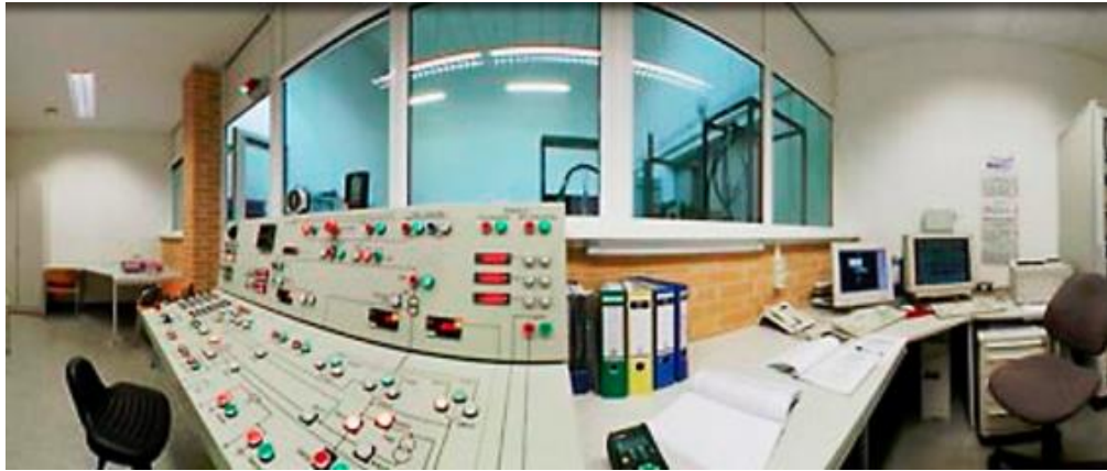
圖 20. 絕緣礙子、套管和避雷器測試控制室
