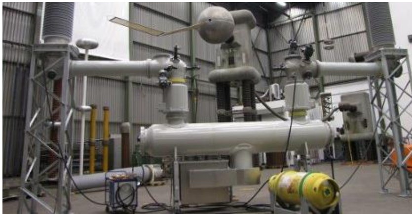
圖 19. 高壓開關組件和開關設備實驗室
