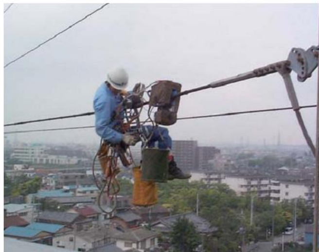
圖 19 導線腐蝕現場檢測
