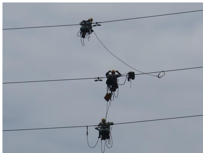
圖 31 Fujikura 執行導線腐蝕檢測(2)
