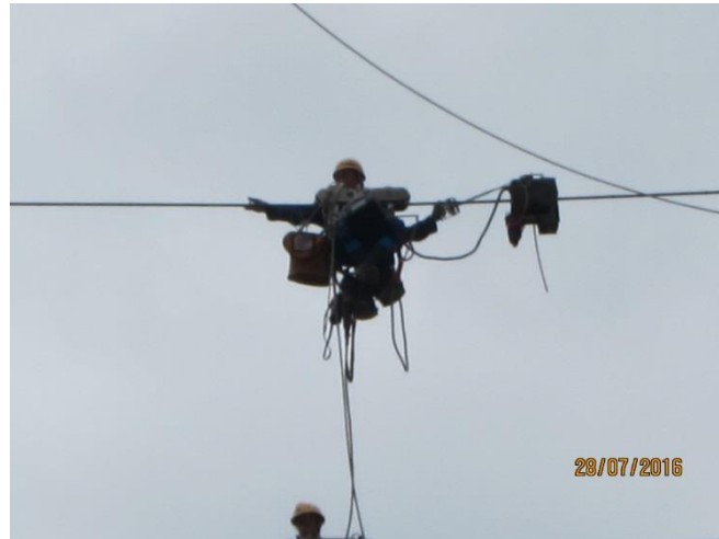
圖 32 Fujikura 執行導線腐蝕檢測(3)
