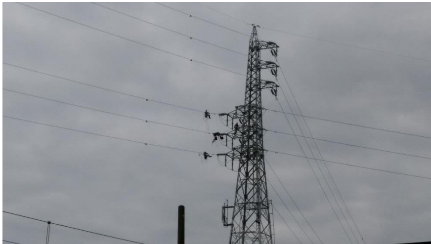
圖 30 Fujikura 執行導線腐蝕檢測(1)
