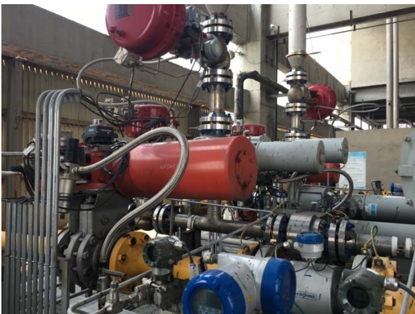
圖十一、氣化爐烘爐設備。
