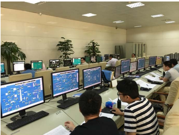
圖五、挾帶床氣化爐控制中心。
