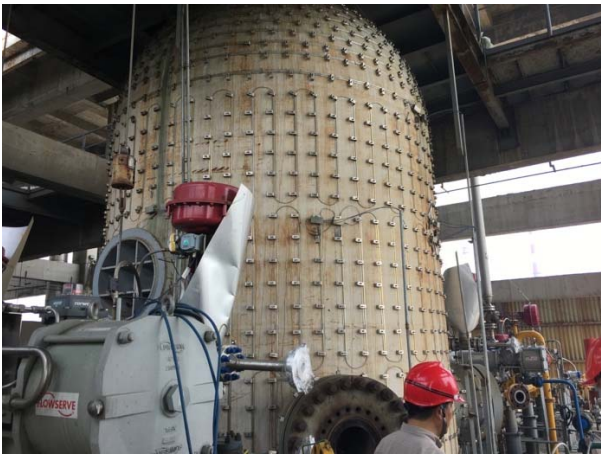
圖九、挾帶床氣化爐頂部。
