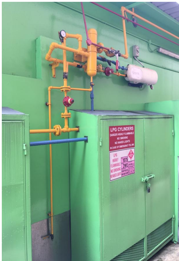
圖 1.10 餐廳外之液化石油氣容器串接系統
