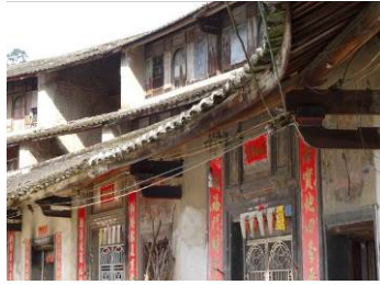
照片 11 龍潭樓內部電線裸露情形
