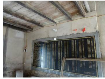
照片 10 水美樓內部電線裸露情形
