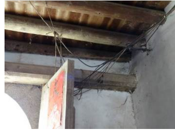
照片 12 光裕樓內部電線裸露情形
