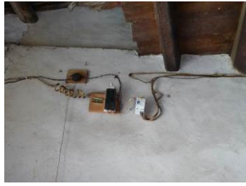
照片 9 廣福樓內部電線裸露情形
