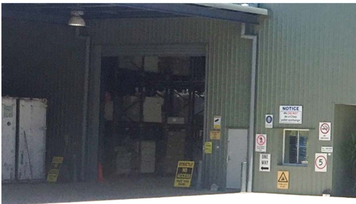
附圖 12、出入口採鐵捲門設計並張貼警告標識
