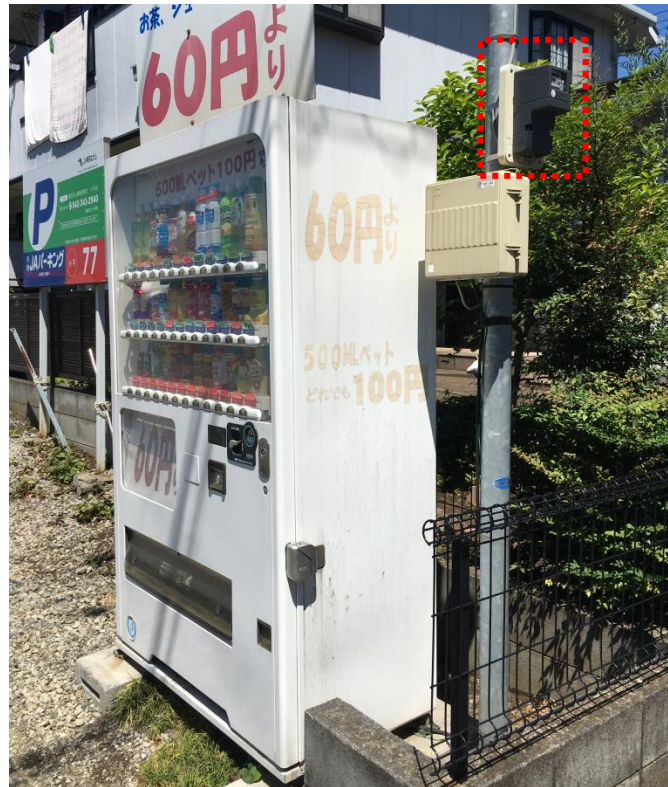
圖 26 販賣機專用電表安裝位置
