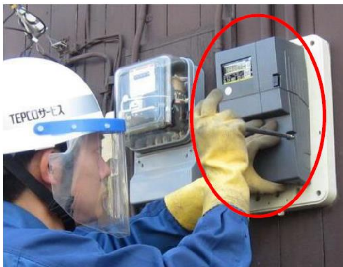
圖 22 TEPCO 第一批安裝於小平市的低壓智慧型電表
