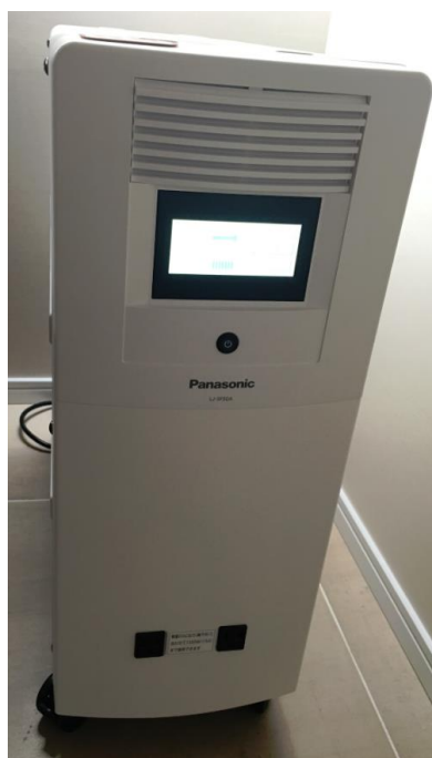
圖 4 智慧家庭展示屋內蓄電池
