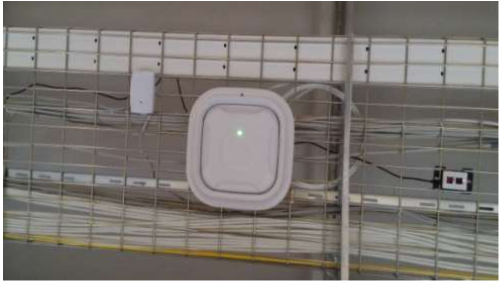
圖 3-4 設置於建築物天花板的感測器與無線設備
