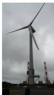
(1) 風力發電機外觀
