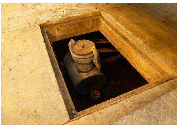
圖 2-19.蒸氣管線埋於地下，由鍋爐燒熱蒸氣，加溫至 140~150°C 送入溫室田間進行燻蒸。
