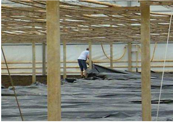
圖 2-21. 田間操作人員將塑膠布均勻鋪放於土面上，以梁柱為邊界，確認鋪好拉滿。
