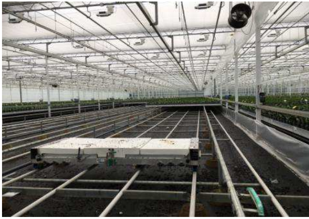
圖 5-11.盤床移動機，可前後移動盤床至溫室前後兩端的走道，再經由走道上的盤床輸送機送往指定位置。
