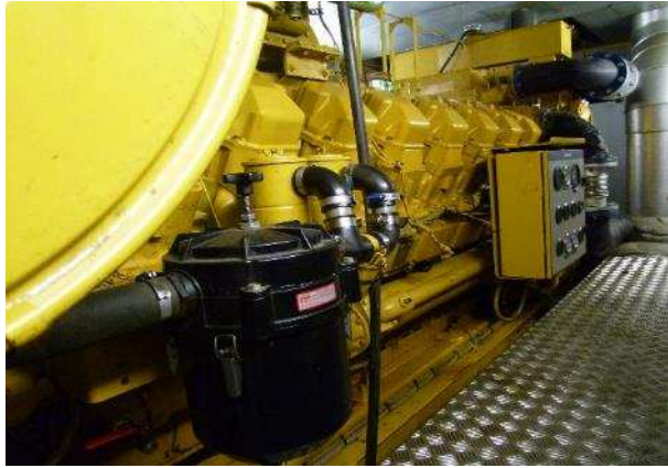
圖 2-27.汽電共生系統，使用天然氣做能源，自主供電。
