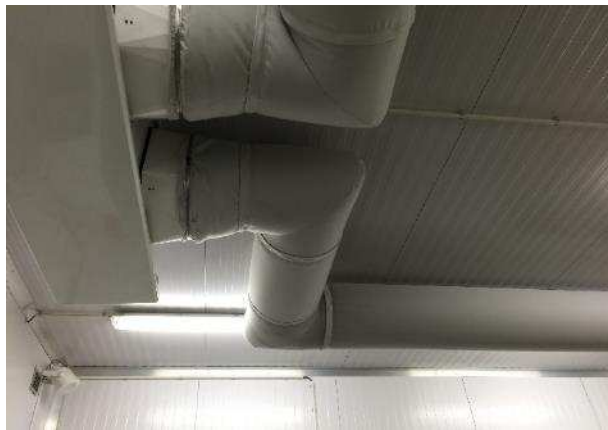
圖 4-9.冷氣出風口接上大布管，使冷氣可以均勻散佈在瓶插室內。
