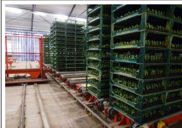
圖 4-17.堆疊完成的育苗籃一排一排的放置在排箱區，經由排箱機鋪排至輸送帶上，並經消毒處理後由機械手臂排列至平台。
