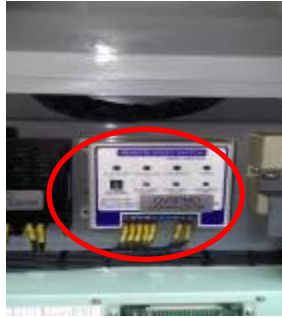
引擎超速檢測器
