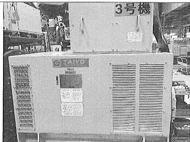
發電機電機頭，廠牌TAIYO
