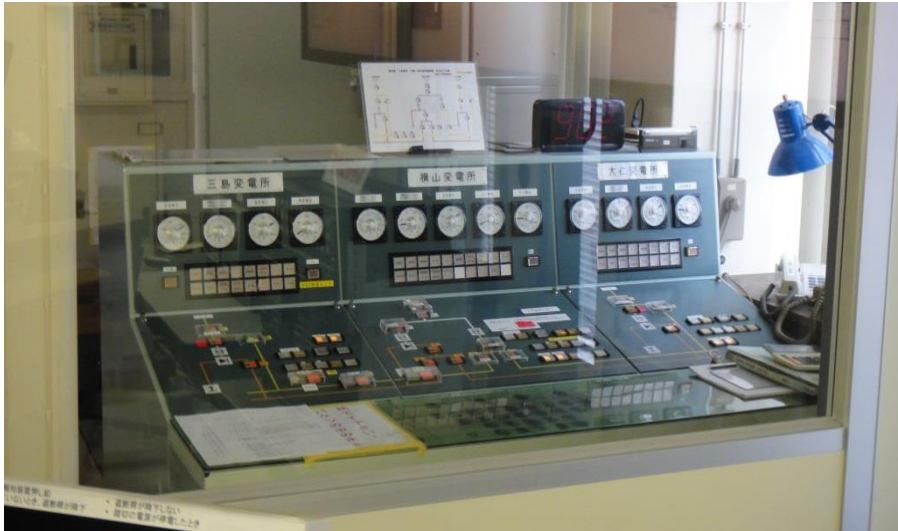
圖59 伊豆箱根鐵道駿豆線電力調配室
