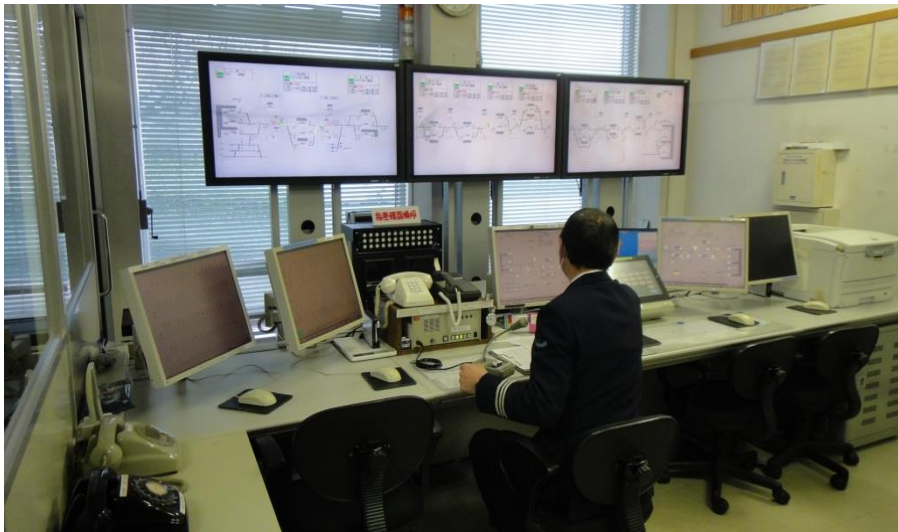
圖57 伊豆箱根鐵道駿豆線運轉指令室
