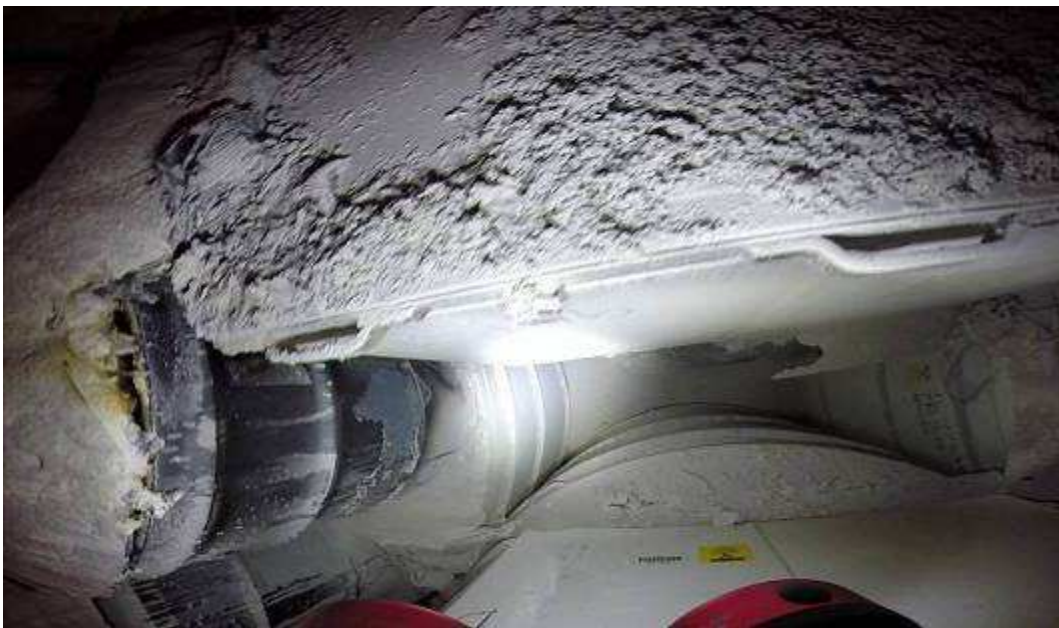
圖 16 WIPP 第 7 區第 7 室材料受熱溶化與處置容器頂蓋開裂情形
