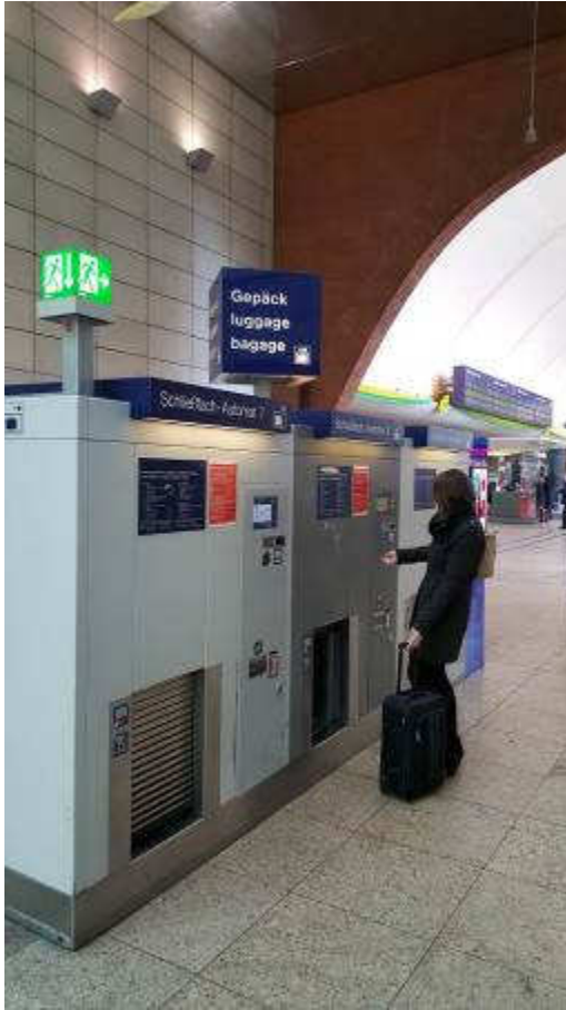
圖4.10 車站行李暫存設備
