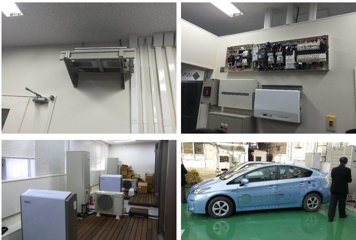
圖26、電表集中器、PV inverter、儲能設備與電動車等各式智慧屋內部設備
