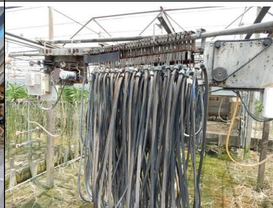
圖44.由韓國進口及改良的軌道噴水設備
