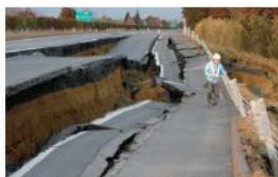
東日本大震災の発生により被災した常磐自動車道 出典：国土交通省ホームページ
