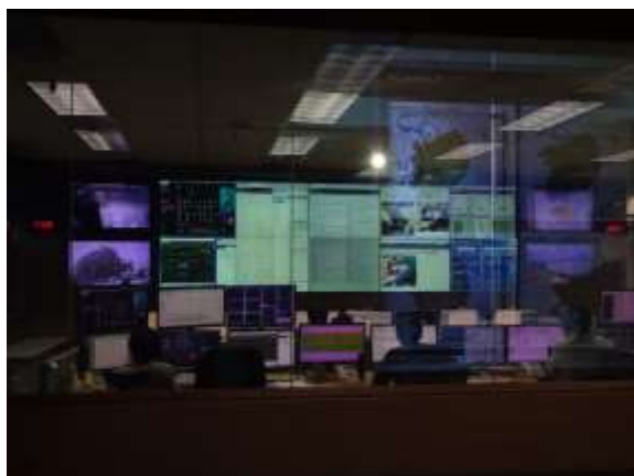
KMA 訊息通訊技術中心內部情形
