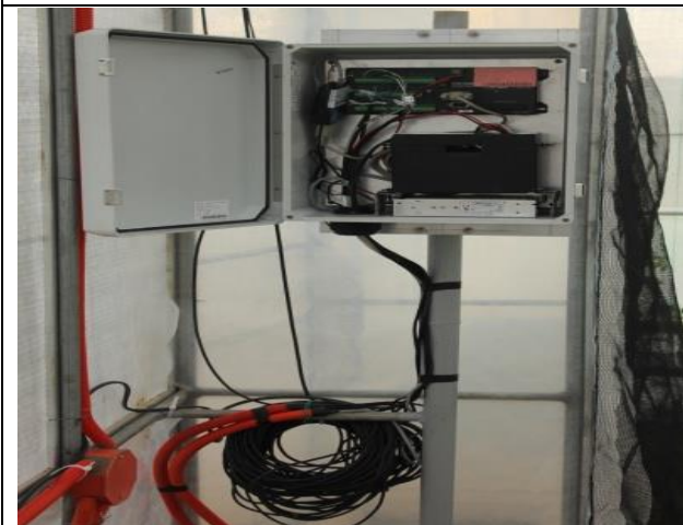
圖 5. 組裝完成之資料收集主機及供電系統
