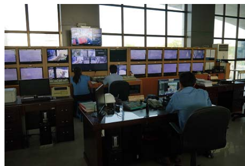
照片 NAVIS System 現場狀況
