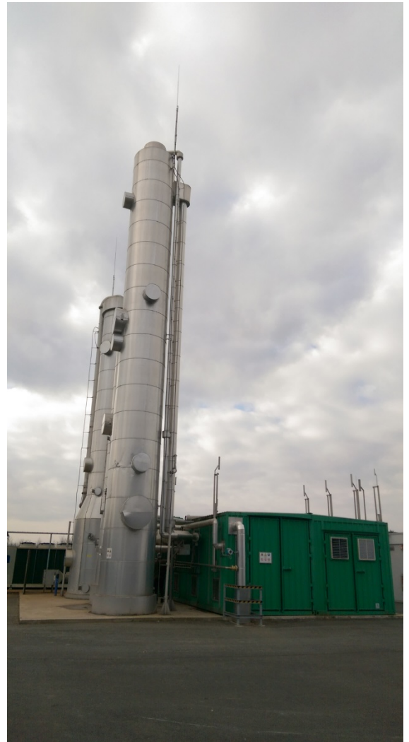
圖 10. 純化系統與發電機室
