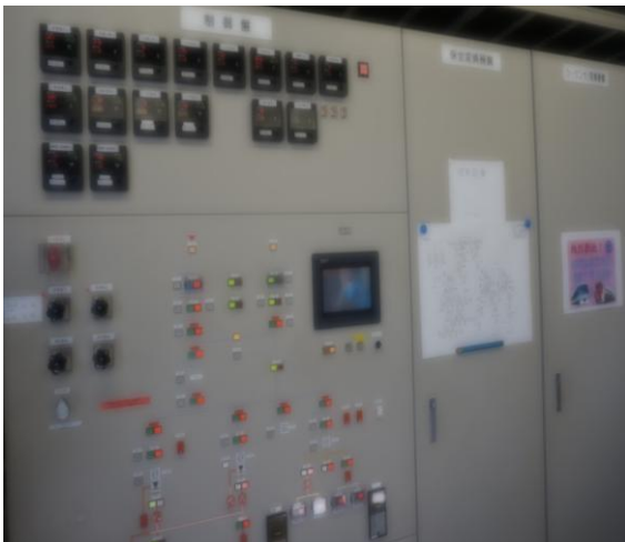
圖 37 變電站控制盤
