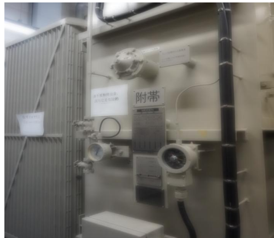
圖 38 變電站主變壓器
