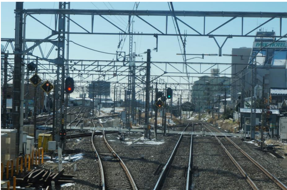
圖 33 西武新宿線電車線設備
