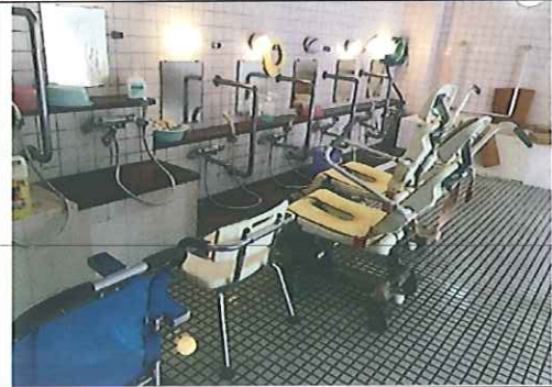
圖 15 護理之家衛浴設備
