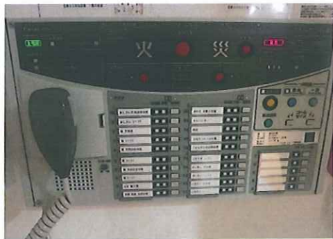
圖 30 老人之家火災聯繫設備
