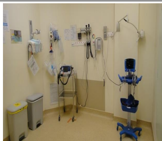
隔離病室內設備
