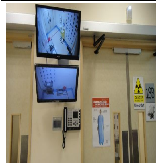
隔離病室門外監視器
