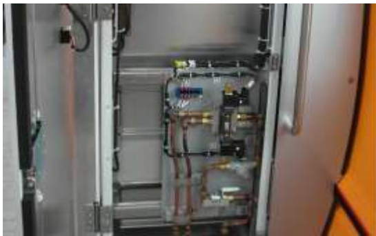
圖 3-23 門機控制設備
