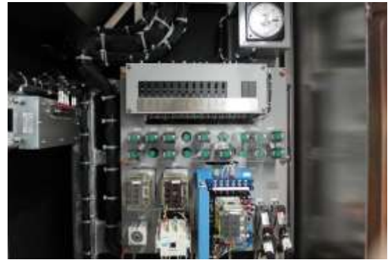
圖 3-28 車上配電盤配線
