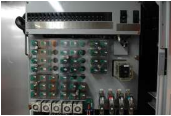
圖 3-27 車上配電盤配線
