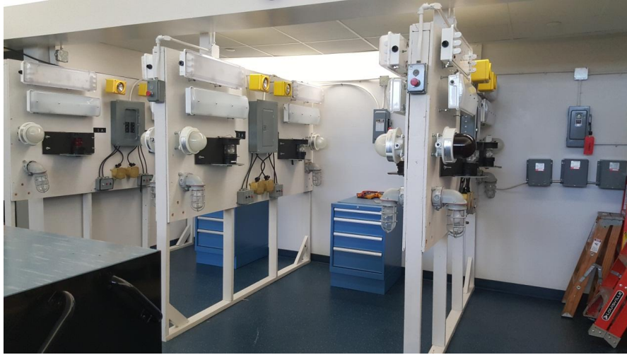
訓練中心之船舶照明設備教室
