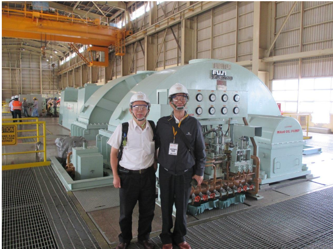
圖 3、督馬庫特地熱電廠的發電機組。
