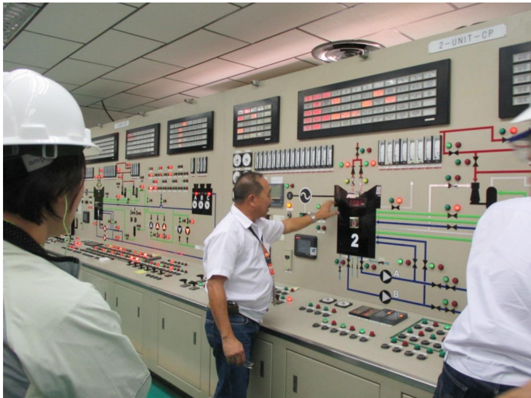
圖 6、解說地熱電廠的操控。
