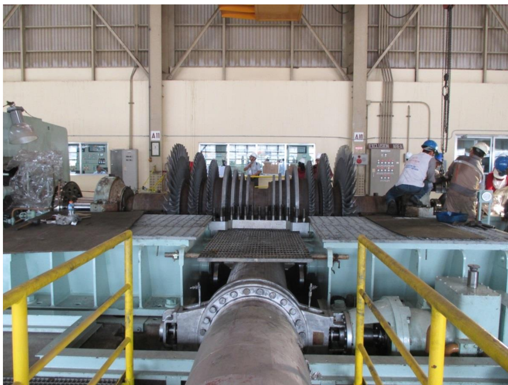
圖 4、督馬庫特地熱電廠的 35MW 之渦輪式發電機維護的情形。
