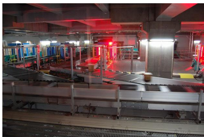
圖16 高速分揀設備 12
