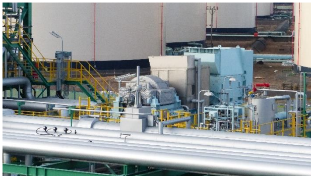
圖 14 供氣(PSA 分離氣體)壓縮機
