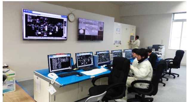
圖 13 DCS 控制與監測室
