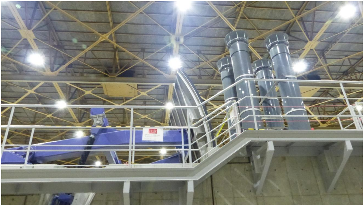
圖 28 海嘯物理模擬器放流控制閘門暨平壓排氣管
