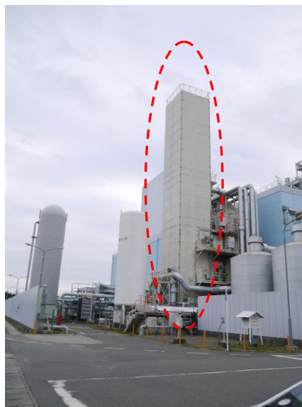
圖 10 空氣分離系統塔
