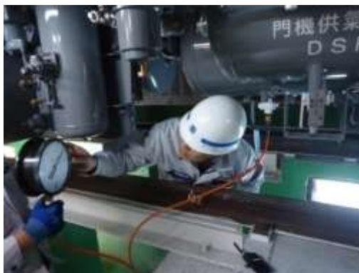
圖 2-23：空壓機除/復壓壓力檢視
