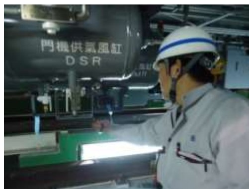
圖 2-26：排水閥作動確認
