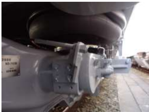
圖 2-44：改善調整後之拉桿位置。
