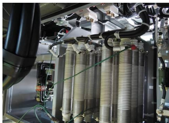
圖3-65 高壓電路控制箱
