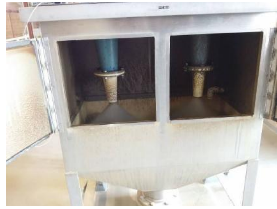
Foothill 淨水場 Sand/Sludge 混凝設備
