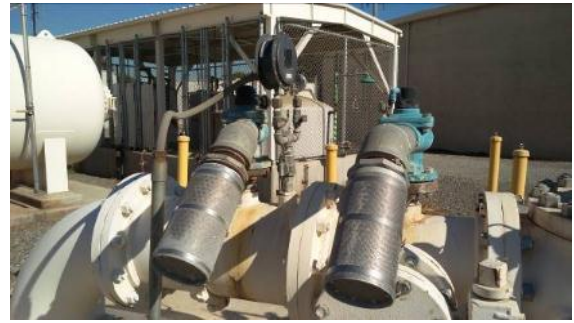
馬達排氣閥(加裝濾罐)
