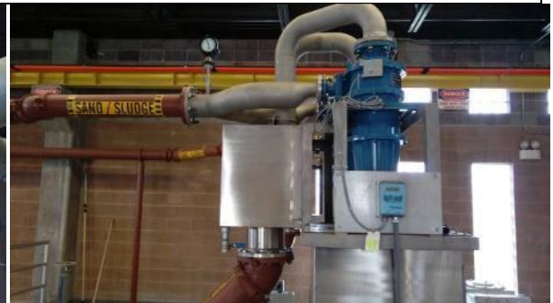
Foothill 淨水場 Sand/Sludge 混凝設備
