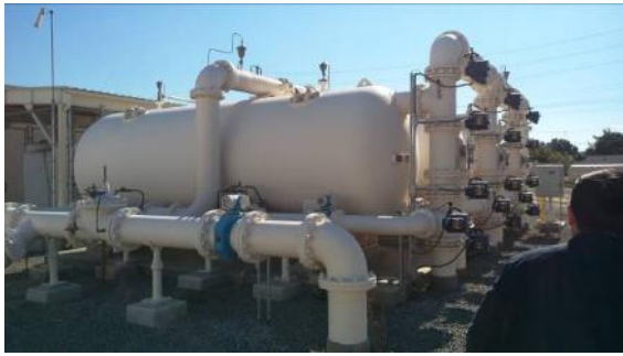
Lakewood 市淨水場快濾筒設備
