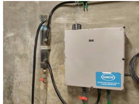
Foothill 淨水場水質監控設備
