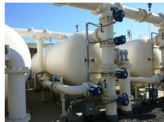
Lakewood 市淨水場快濾筒設備
