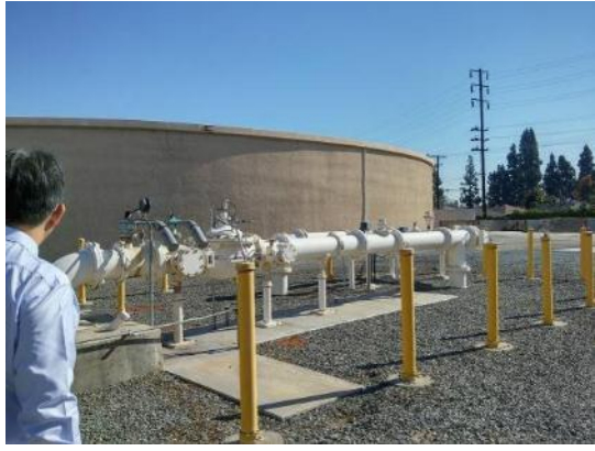
Lakewood 市淨水場清水池與輸送管線
