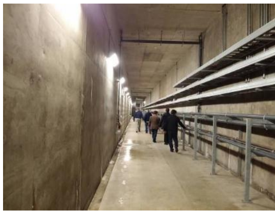
Fairbairn 淨水場地下管道間
