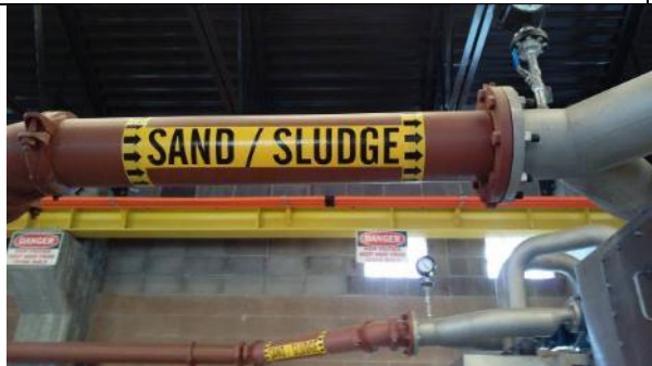
Foothill 淨水場 Sand/Sludge 混凝設備
