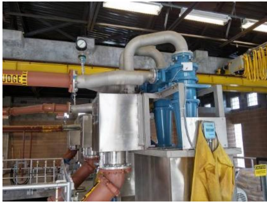
Foothill 淨水場 Sand/Sludge 混凝設備
