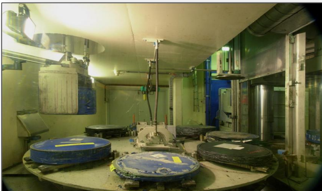
圖 20、BELGOPROCESS 超高壓壓縮機
