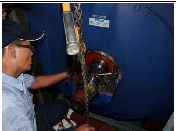
圖 2. 發電機後蓋軸承拆解
