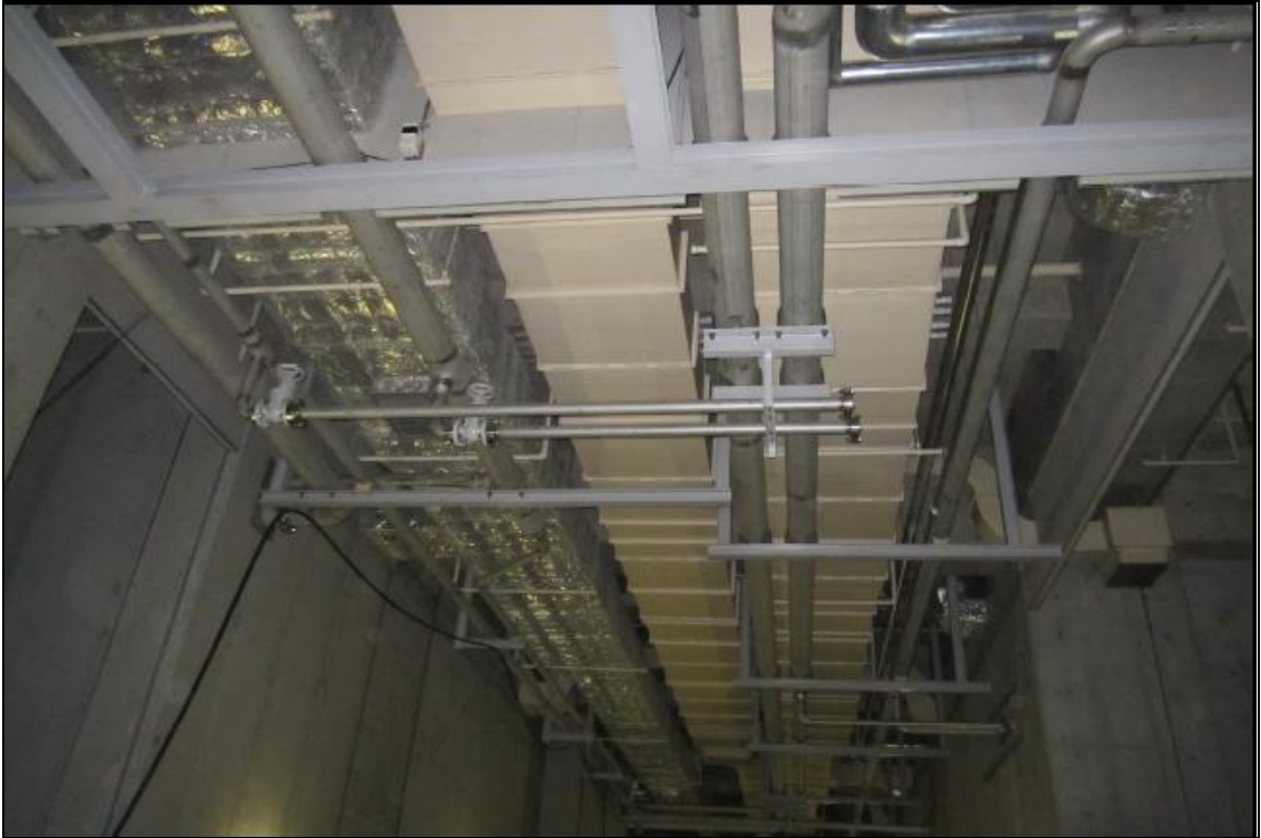
三宮變電所地下層共通管路簡潔之配管現況
