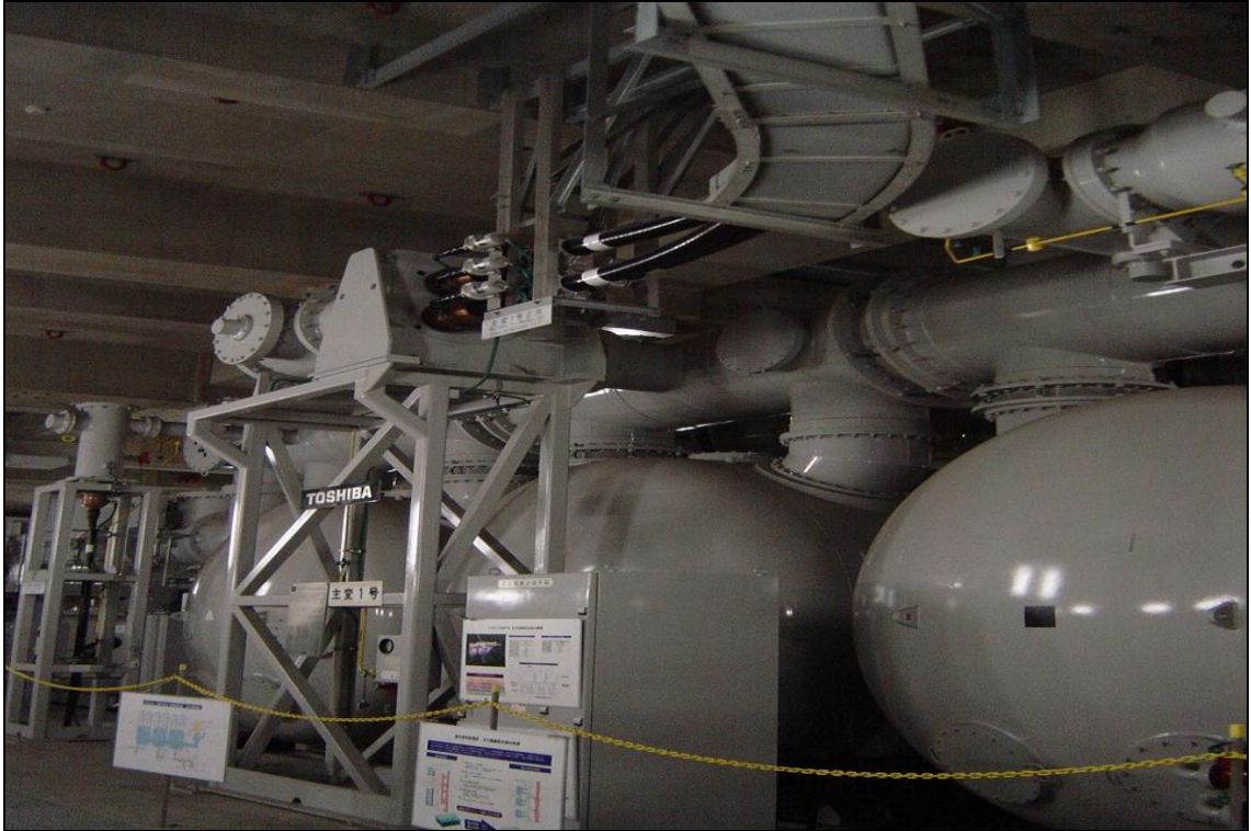
275kV 300MVA 氣體絕緣開關變壓器
