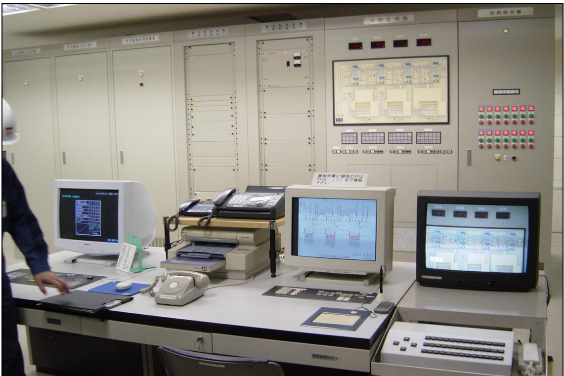
水冷卻系統採用 PLC 監控
