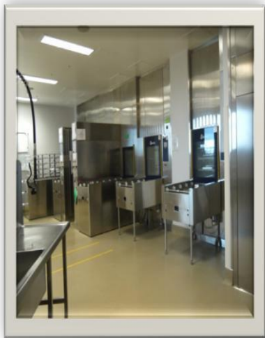
隧道室器械清洗機
