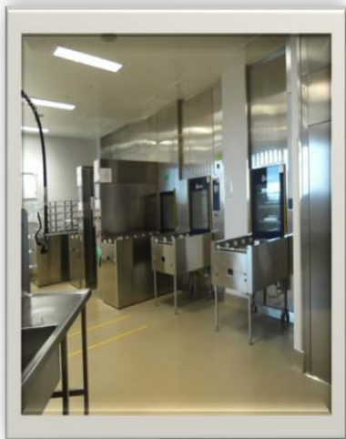
隧道室器械清洗機
