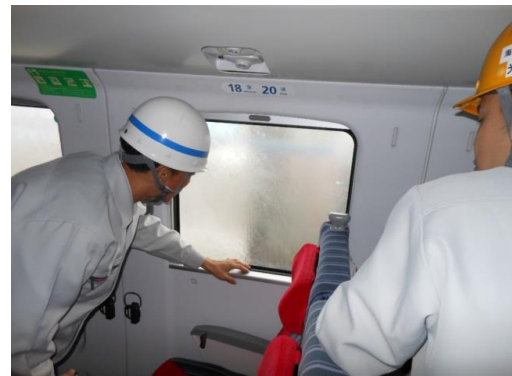
圖 1-87 車窗雨漏檢視
