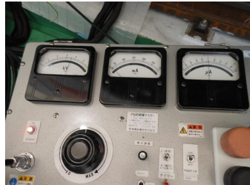
圖 1-32 TEP2035 高壓耐壓測試(3.5KV)
