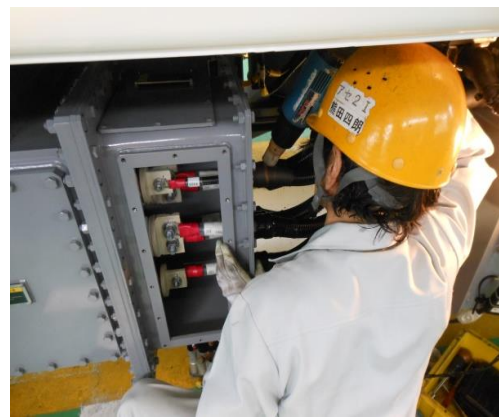
圖 6-4 主變壓器內電纜接線
