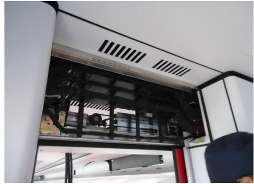
圖 1-91 走道門雨漏檢視
