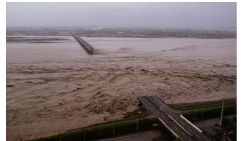
写真18 洗掘等により倒壊した橋梁
