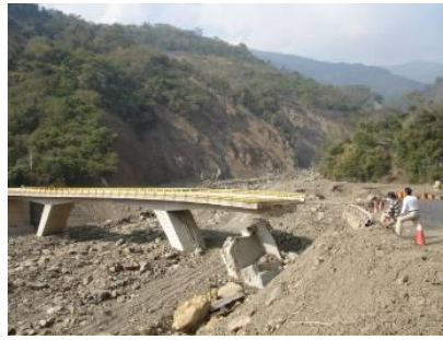
写真15 橋台のみが破壊された橋
