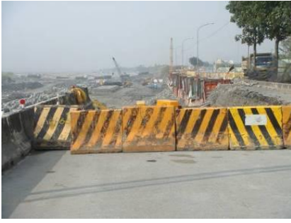
写真7 道路1車線分の侵食
