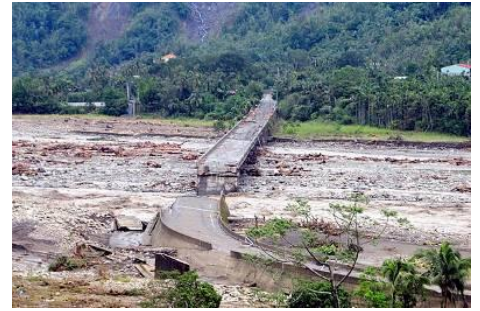
写真16 取付部が破壊された橋
