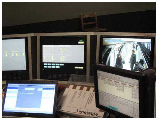
行車調度與監視控制台控制電腦 2
