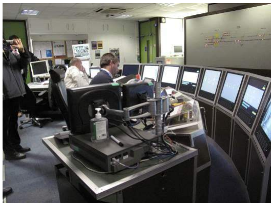
行車調度與監視控制台
