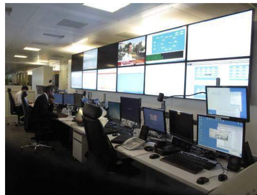
控制中心控制台
