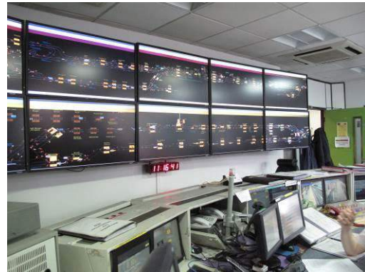
行車調度與監視控制台 2
