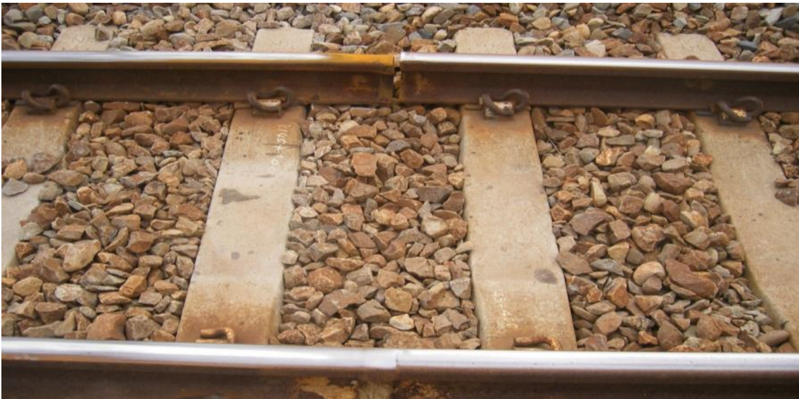
圖 柒-1 臺鐵斷軌情形絕大多數發生於熱劑焊接處
