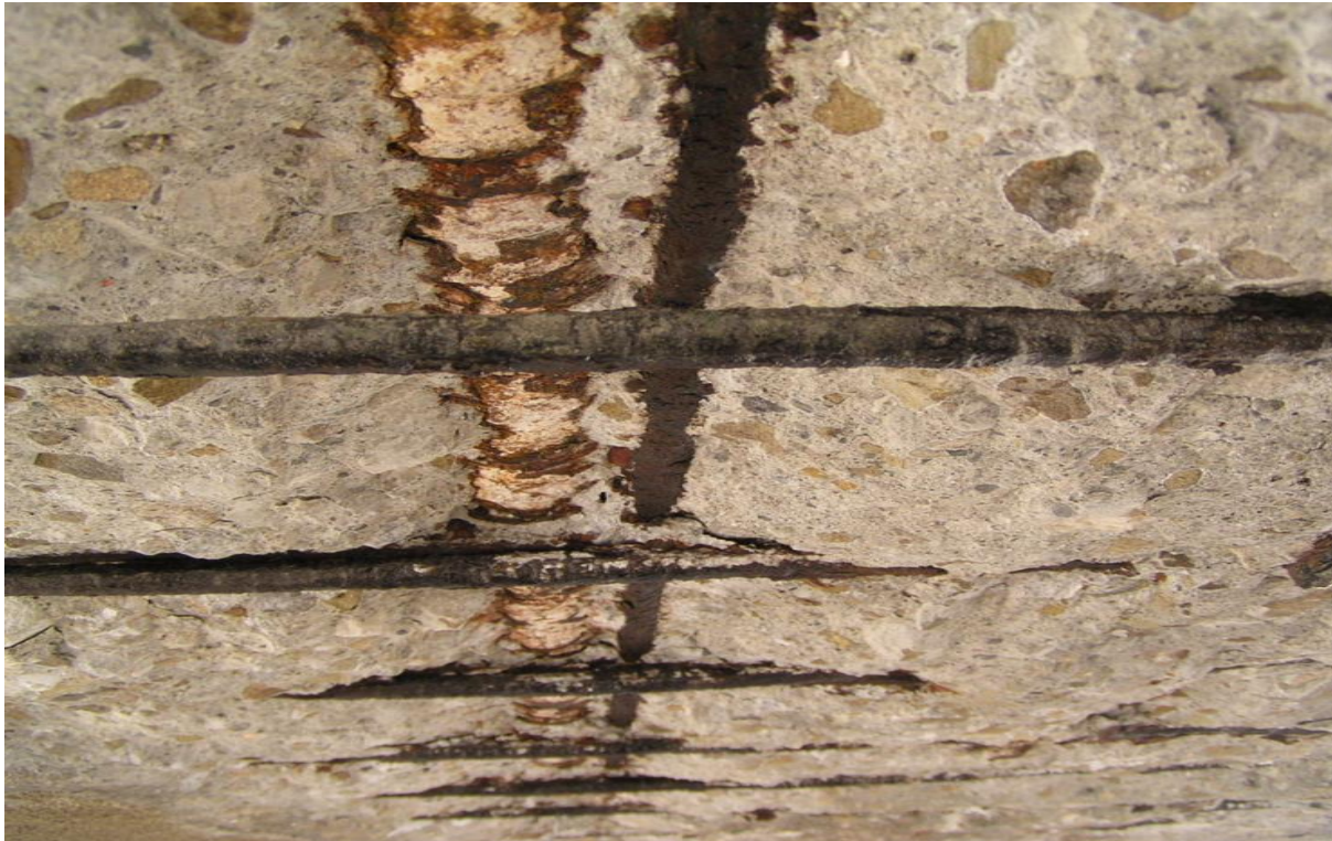
圖 伍-4 鋼筋腐蝕、混凝土剝落以及斷面減少例
