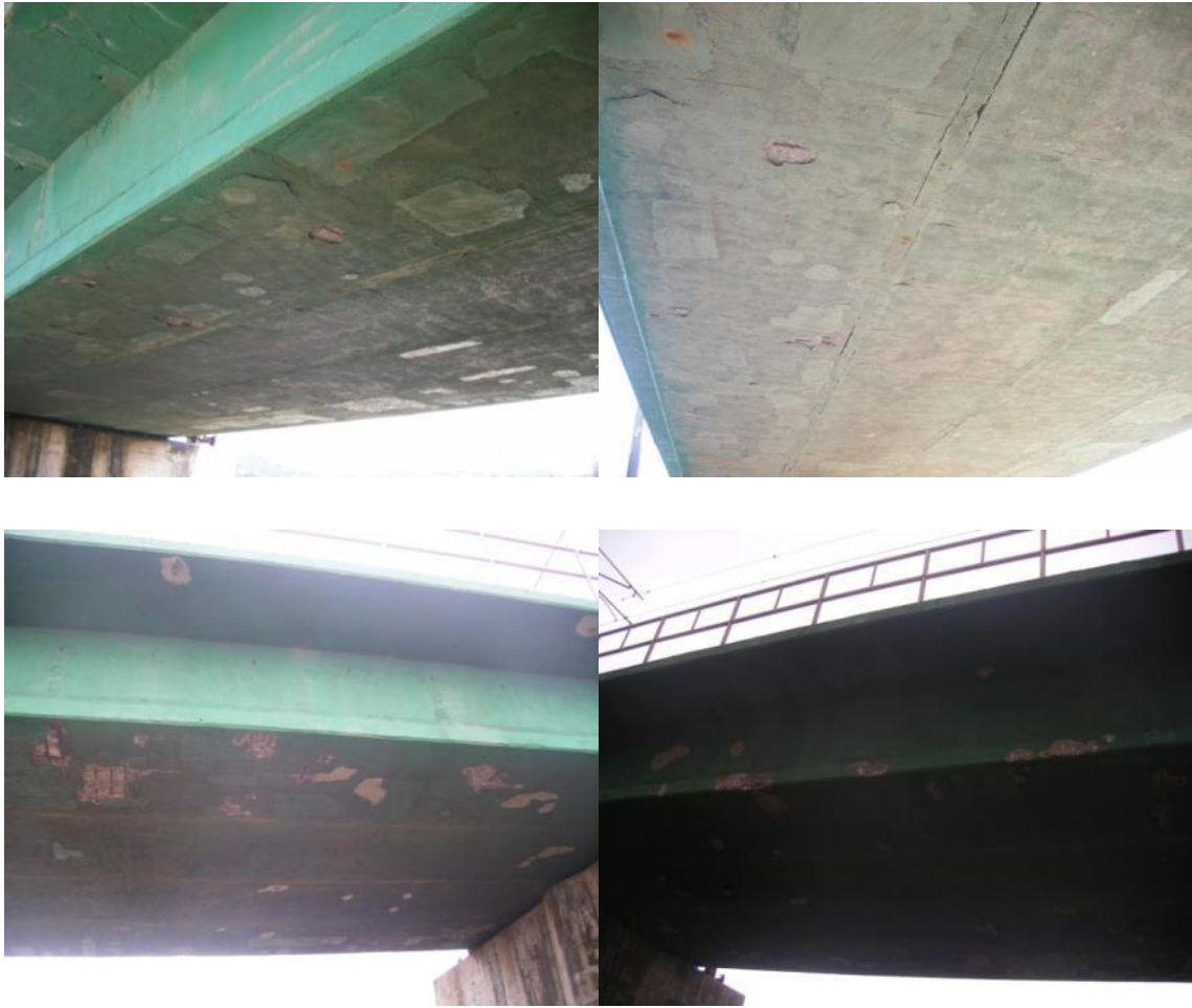
圖 伍-17 98 年間橋梁底版再度鋼筋鏽蝕混凝土剝落情形
