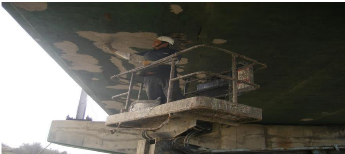
圖 伍-18 100 年間橋梁底版鋼筋鏽蝕混凝土剝落情形，並再度發包施工
