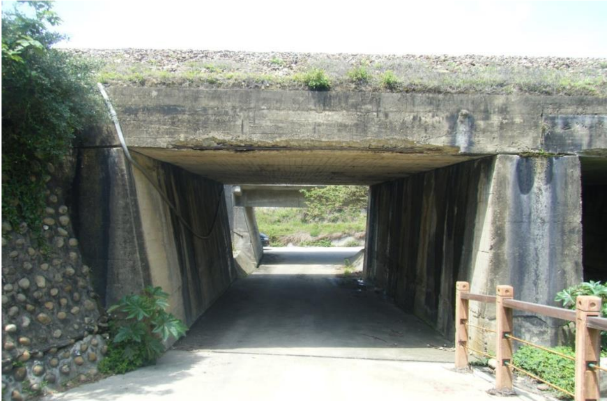
圖 伍-1 臺鐵海線龍港-白沙屯間箱涵，混凝土剝落情形
