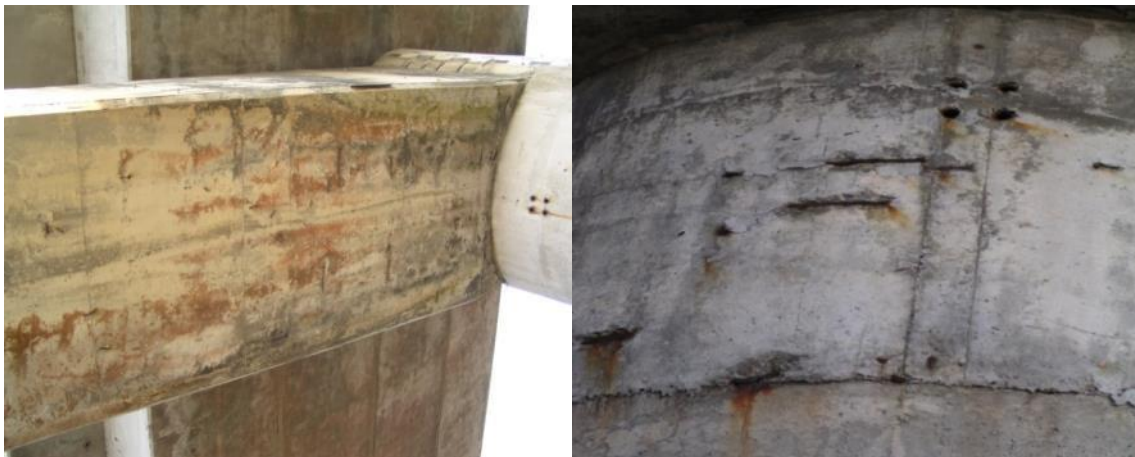
圖 伍-11 92 年下三叉河橋 P8 帽梁及 P11 橋墩鋼筋腐蝕混凝土剝落情形
