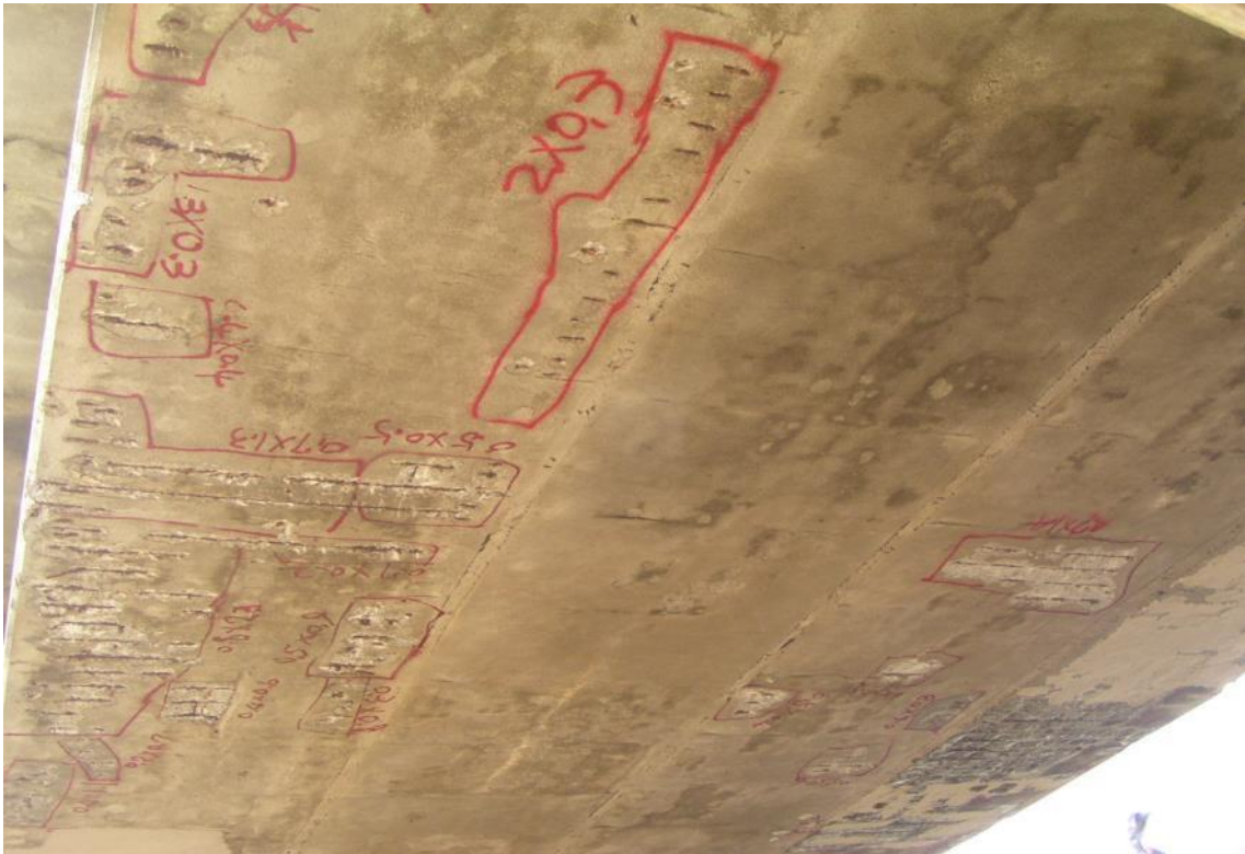
圖 伍-12 92 年施工步驟之敲除混凝土鬆脫部分至堅實面，並記錄待補修面積
