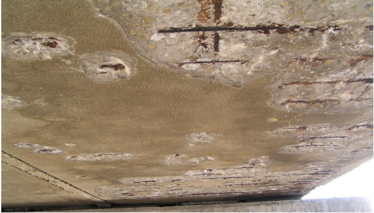
圖 伍-10 92 年下三叉河橋橋底板鋼筋腐蝕混凝土剝落情形
