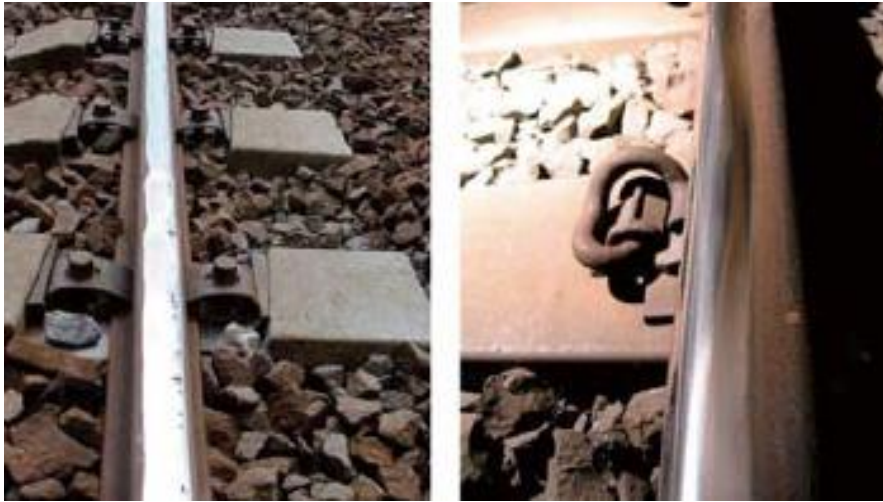
圖 陸-1 鋼軌波狀磨耗實例
