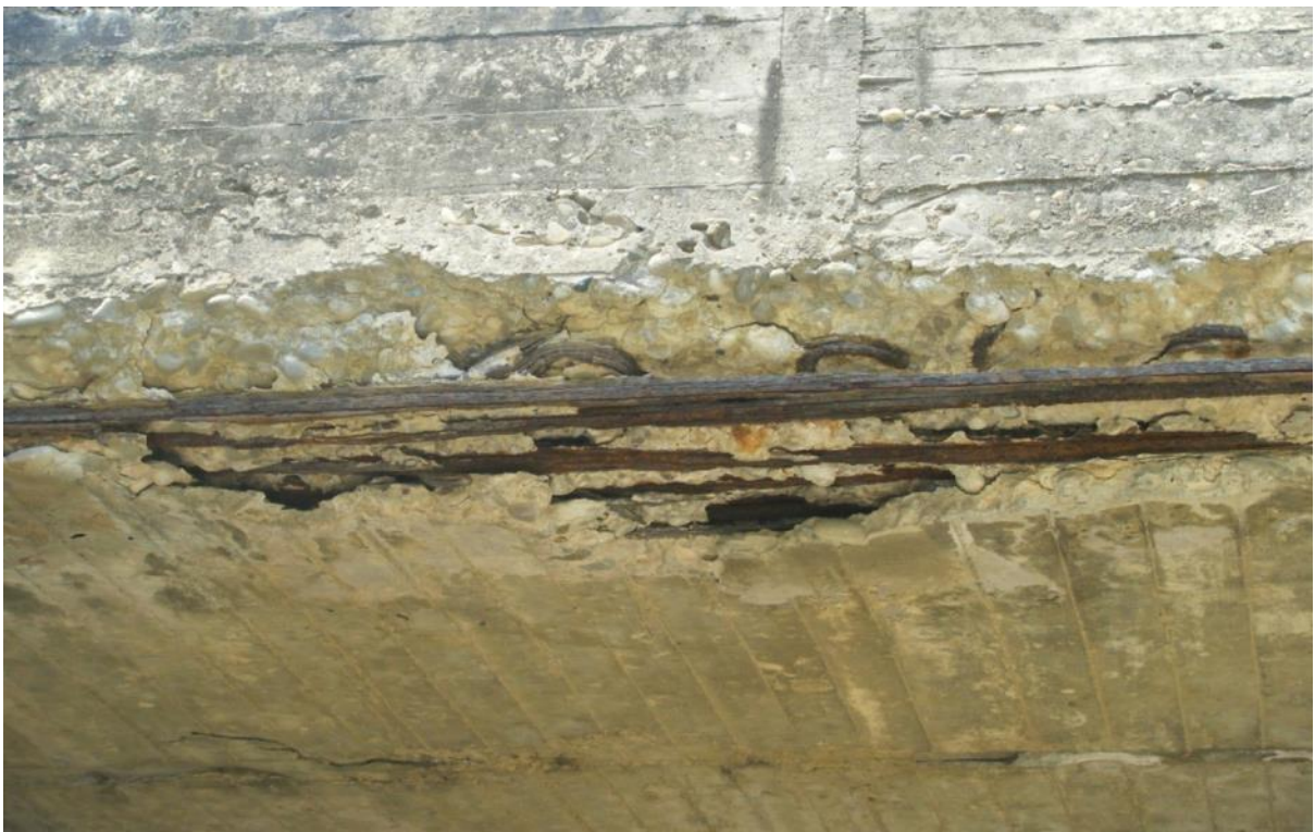
圖 伍-2 版梁下部鋼筋斷面減少，恐影響結構安全
