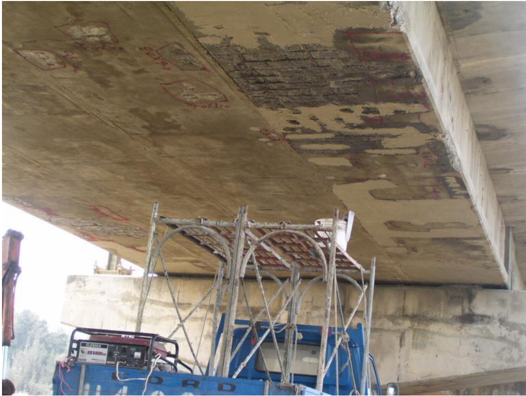
圖 伍-13 92 年施工步驟之塗佈新舊混凝土接著劑及混凝土補修材披覆
