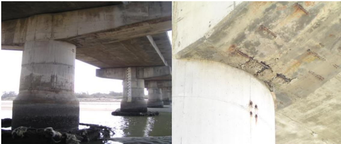
圖 伍-7 民國 91 年下三叉河橋 P7 西側帽梁劣化情形
