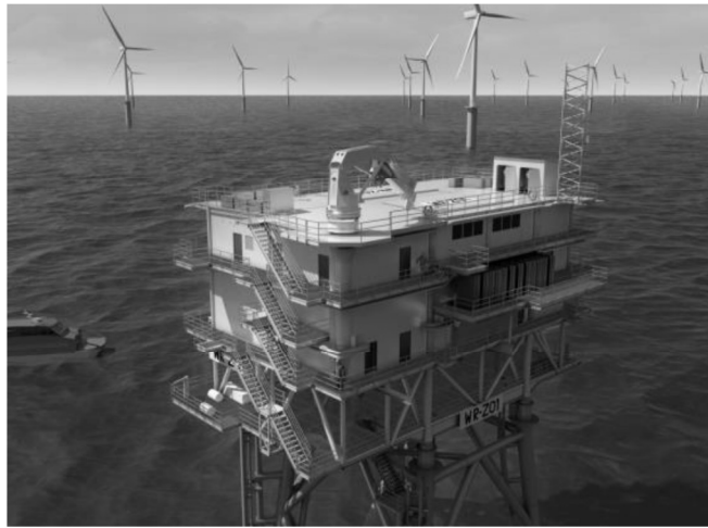
圖 4.5.4-8 風電場海上升變站(5)
